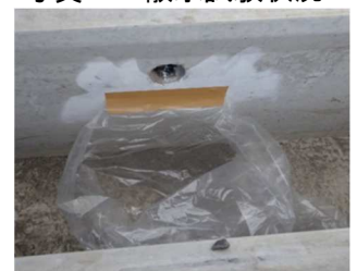
写真-6 水抜き孔
