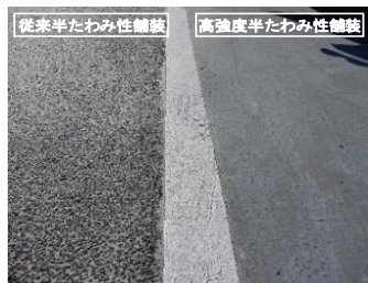
写真-15 供用 8 ヶ月後の状況
