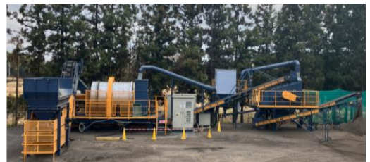
写真-2 すりもみ骨材製造設備全景
