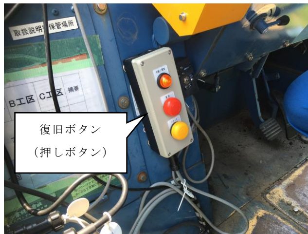
写真-9 システム復旧ボックス
