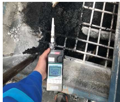
写真-2 脱臭装置 OFF 時
