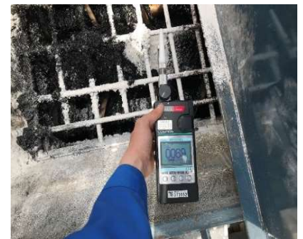
写真-3 脱臭装置 ON 時
