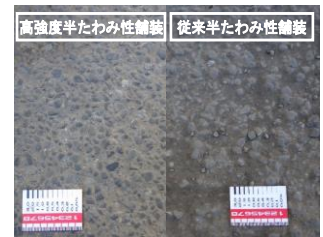
写真-11 路面状況(接写)
