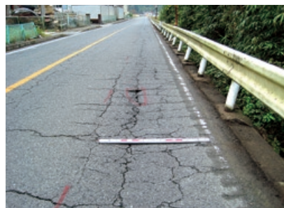
施工前の路面状況
