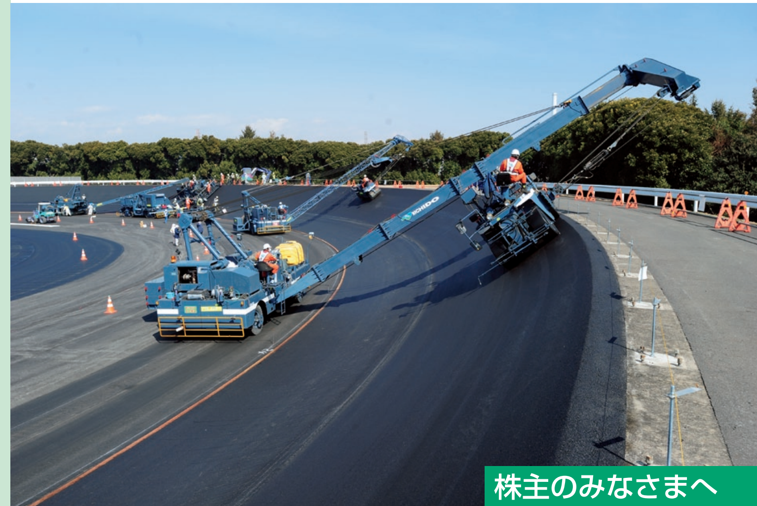
交通安全環境研究所自動車試験場走行路改修工事／埼玉県
