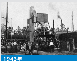
1943年 当時のアスファルトプラント
