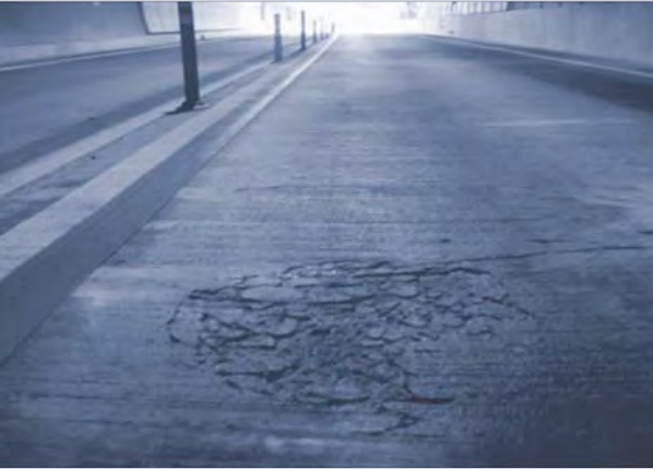
近畿自動車道紀勢線 馬越トンネル舗装工事 不具合箇所
