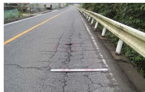
施工前の路面状況
