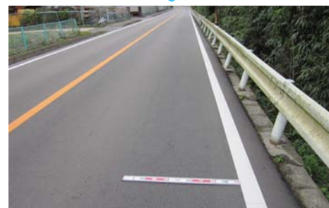
供用2年後の路面状況
