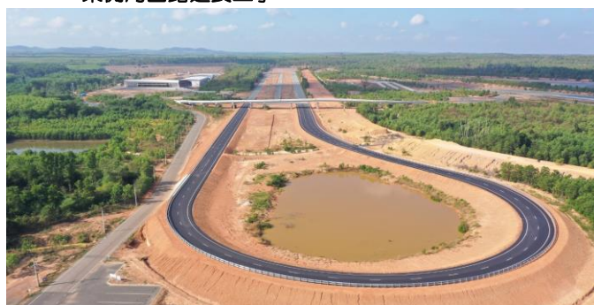
【タイ】自動車タイヤ品質テストコース建設工事 東側周回路延長工事
