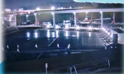
太陽光発電舗装
