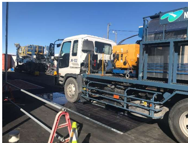
重車両停車状況
