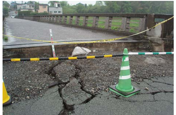
地震により取付部の舗装が約80cm沈下した八竜橋
